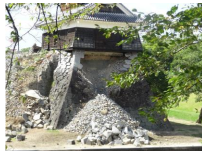
倒壊した熊本城の石垣
